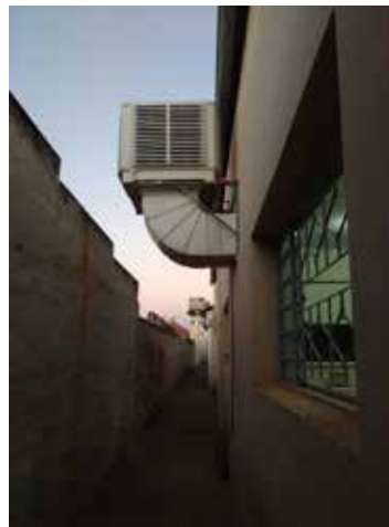
Climatizador instalado na instituição
